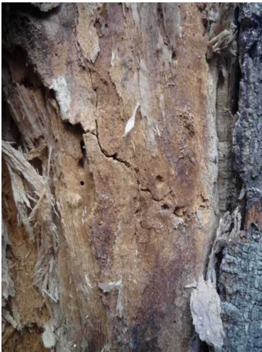
Obr. 21: Detail rozkladu dřeva s příčnými trhlinami v hlavním větvení
